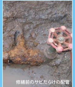
修繕前のサビだらけの配管
